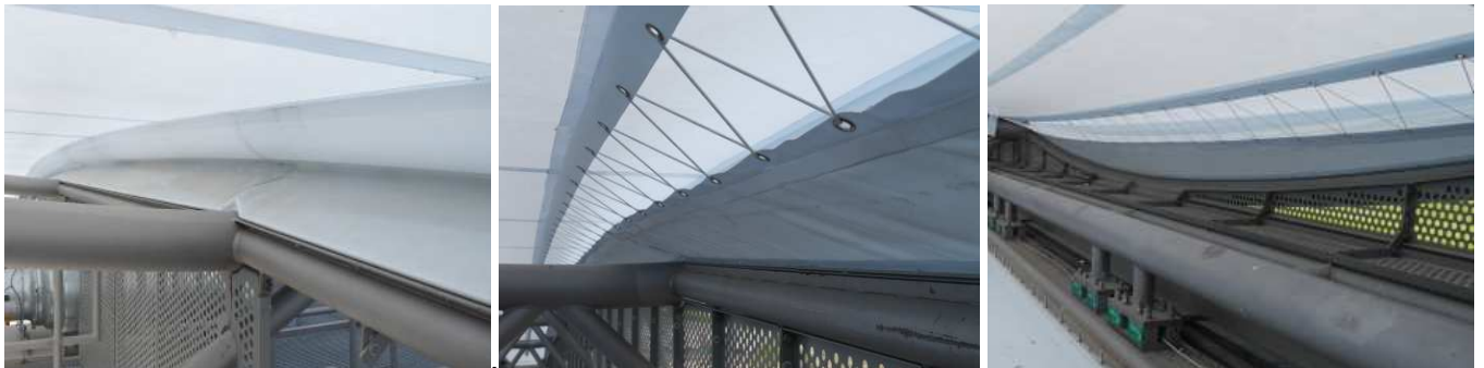
Bilder 16 bis 18: Anschluss der äußeren Membran an das Lochblech mittels einer Membranfalte. Links von außen gesehen, mittleres und rechtes Bild: von innen gesehen.
