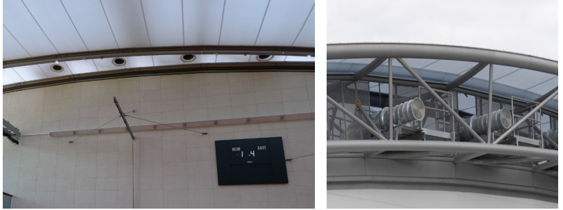
Abbildung C40: Sporthalle Fürth Innenansicht der Entrauchung links und Auslassrohre im Randabschluss rechts
