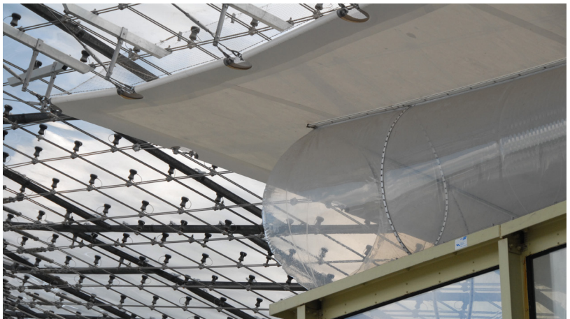
Abbildung C38: Beweglicher Anschluss in der Olympiaschwimmhalle mittels eines ETFE-Schlauchs
