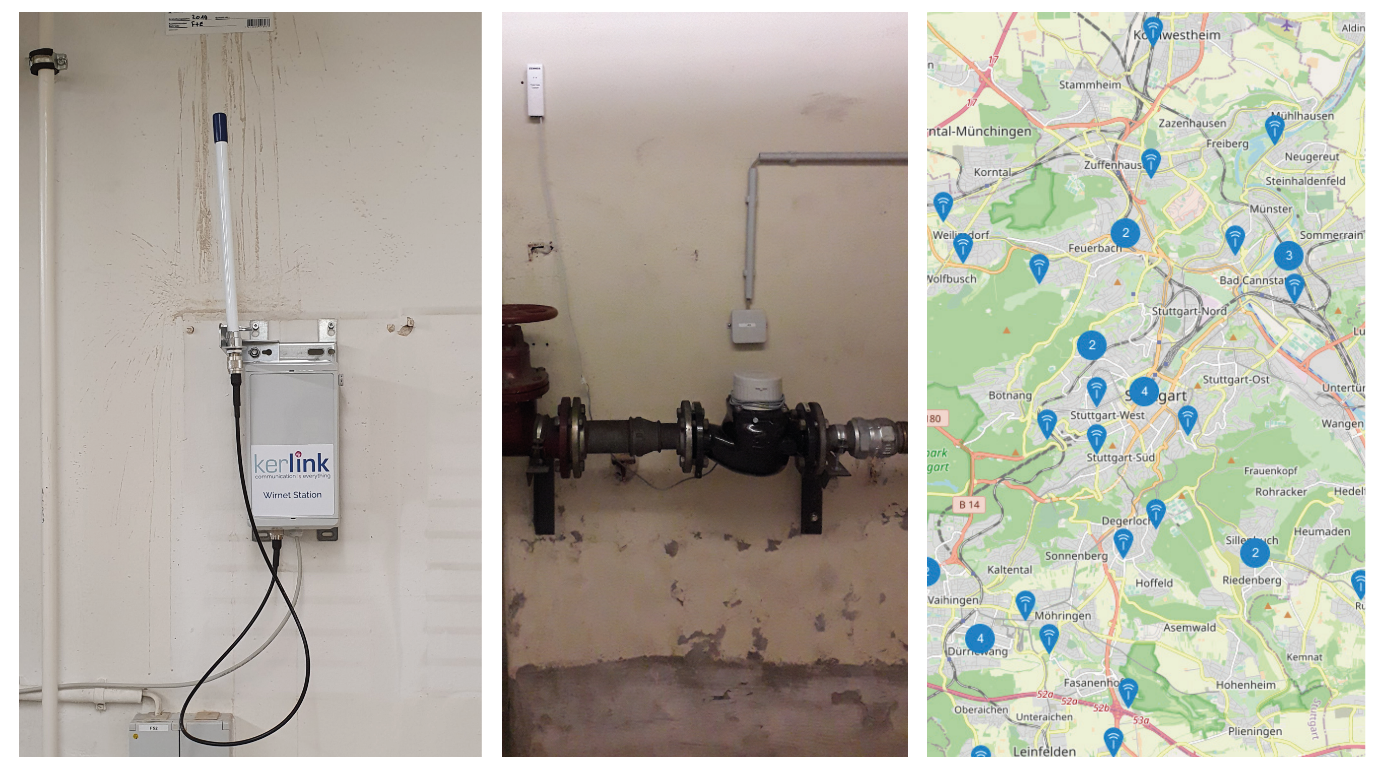
Abb. 2: Aufbau eines offenen LoRaWAN-Netzwerkes auf dem Campus der Hochschule zur Datenübertragung der Hauptzähler aus den Kellergeschossen. Links: LoRa-Gateway, Mitte: Wasserzähler mit Impulsgeber und Kommunikationsmodul, rechts: LoRaWAN-Gateways im Raum Stuttgart (Quelle: TTN).
