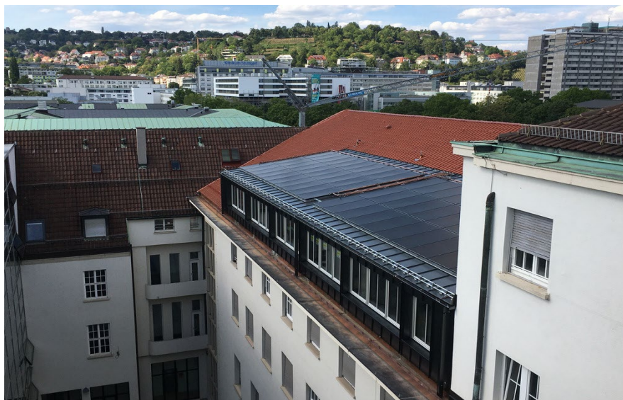
Abbildung 10: Photovoltaik-Thermie-Anlage auf dem Dach von Bau 2 11
