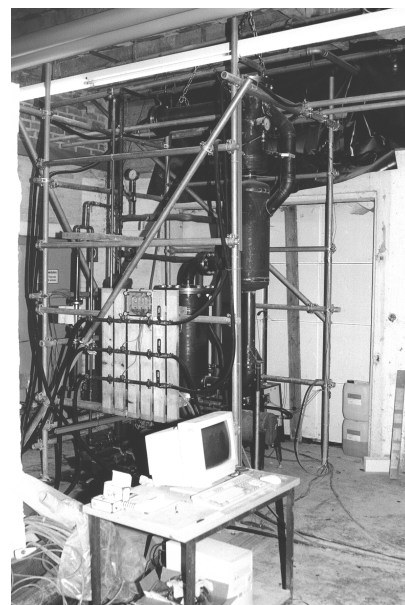
Abb.1: Diffusions-Absorptions-Kältemaschine mit System- und Meßtechnik
