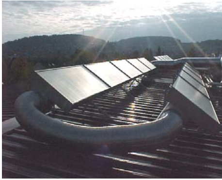
Abbildung 9: 100 m 2 solare Luftkollektoranlage zur Regeneration in der Produktionshalle Althengstett.
