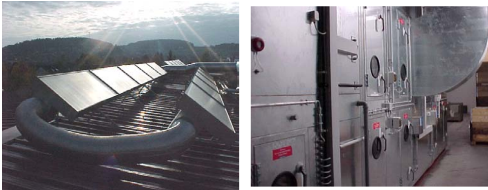
Abbildung 13: 100 m 2 solare Luftkollektoranlage zur Regeneration der Sorptionsanlage in der Produktionshalle Althengstett.
