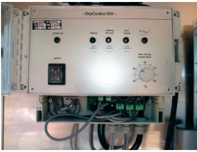
Abb. 2: Regler DryControl in der Nachheizvariante. (Foto HfT Stuttgart)
