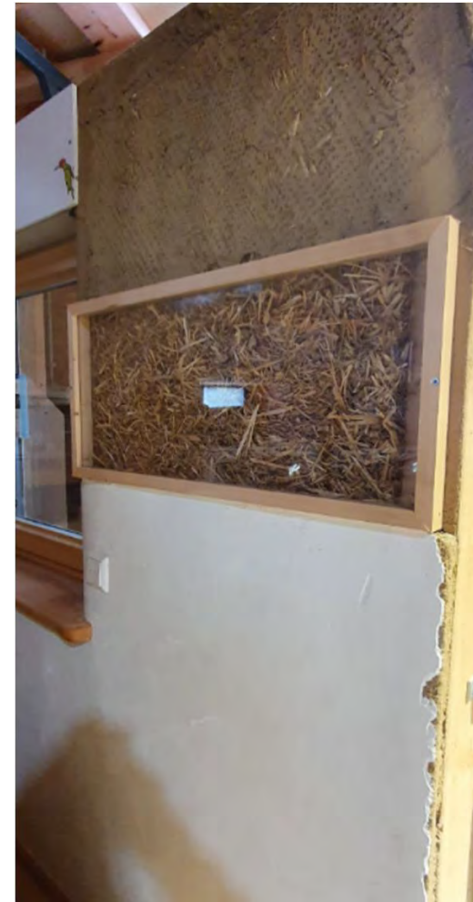
Innenoberfläche aus Lehmputz direkt auf Strohballen(Naturfarbe oder Färbung mit Farbpigmenten möglich), Putzarbeiten auf Baustelle, keine Vorfertigung wegen erhöhten Trocknungszeiten
