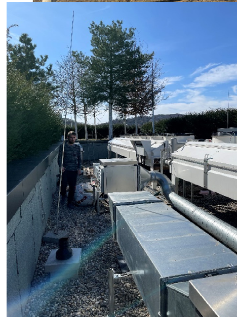
Anlagentechnik auf Hauptdach
