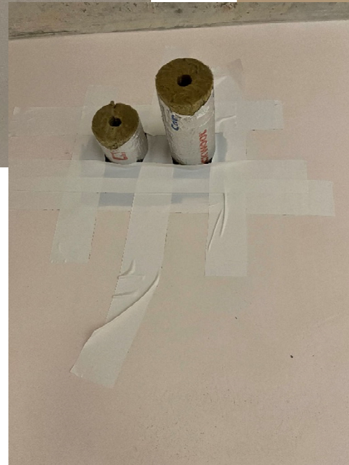
Rohr / Kabel(schacht)- Durchdringungen
