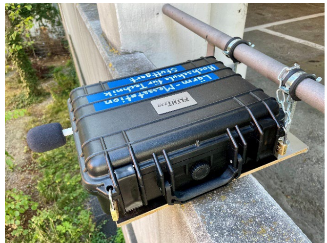
Abbildung 6: Lärmsensor im Schutzgehäuse mit mobilem WLAN-Router und Stromversorgung über zwei Powerbank-Akkus an der Parkhaus-Brüstung.
