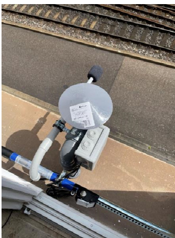
Installation vor den Fenstern
